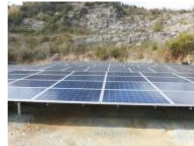
引佐太陽光設備
